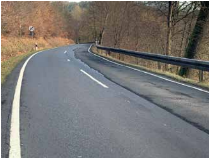
Abgängige Fahrbahnränder und Bankette
